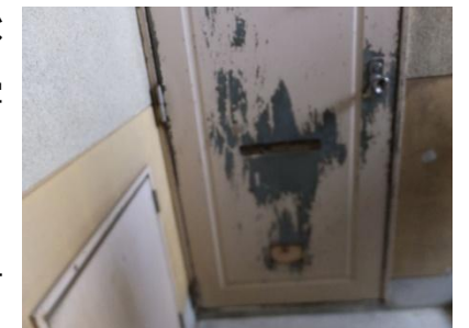
錆びが剥がれた玄関のドア
