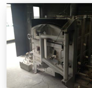
作業所には焼釜が設置
