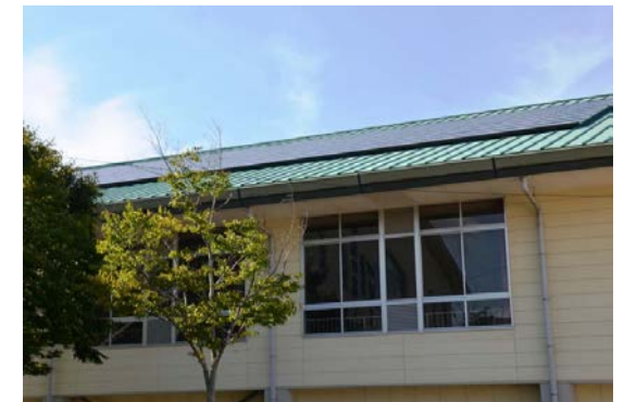
体育館の屋根に設置された太陽光パネル
