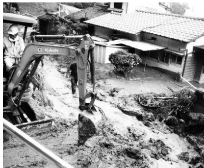
●津浦町の災害現場。近隣住民には避難の指示が。一方で地盤改修のメドはたっていない。
